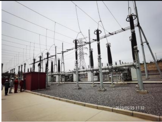
220kV 屋外配电装置区
