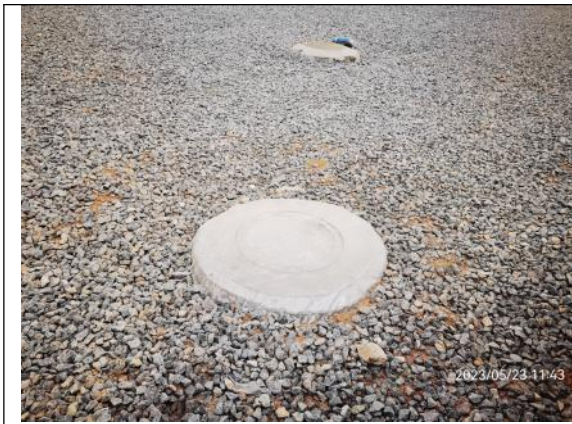
变电站外设置的化粪池
