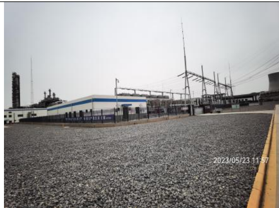
变电站外围墙四周碎石压覆
