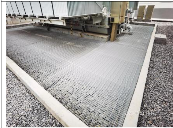
主变下设置的事故油坑
