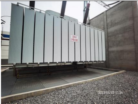
3号主变及其事故油坑
