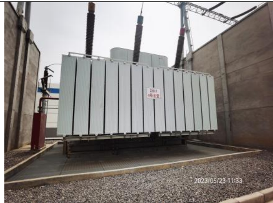
4号主变及其事故油坑
