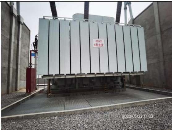
5号主变及其事故油坑
