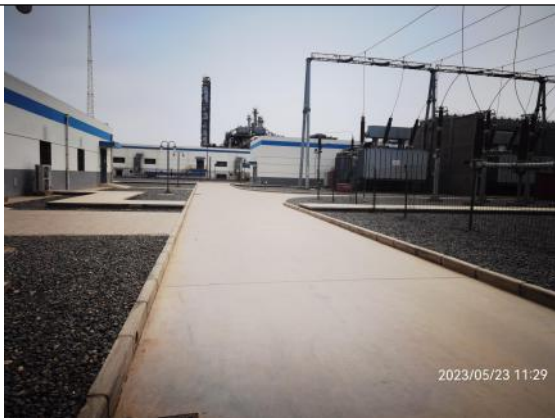
变电站内硬化及碎石压覆
