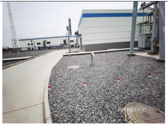
变电站内设置的事故油池
