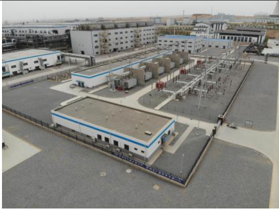
变电站全景近景
