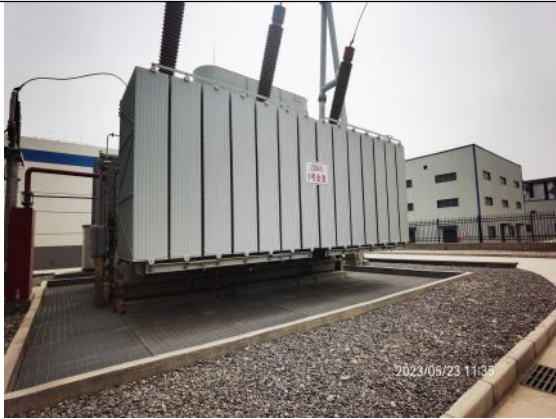
1号主变及其事故油坑
