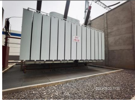
2号主变及其事故油坑
