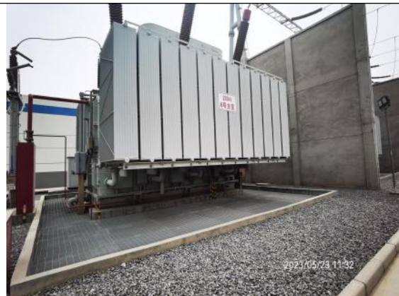
6号主变及其事故油坑
